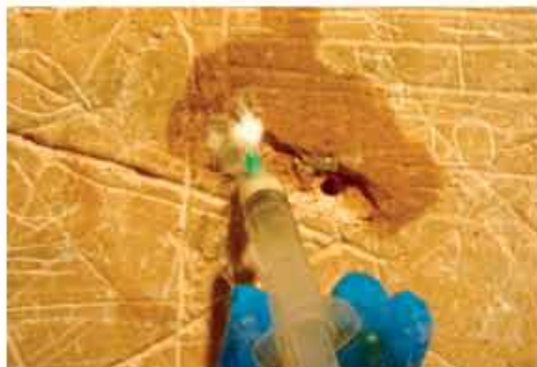
Consolidación de la superficie grafitada con inyección de mortero con propiedad hidráulica.
